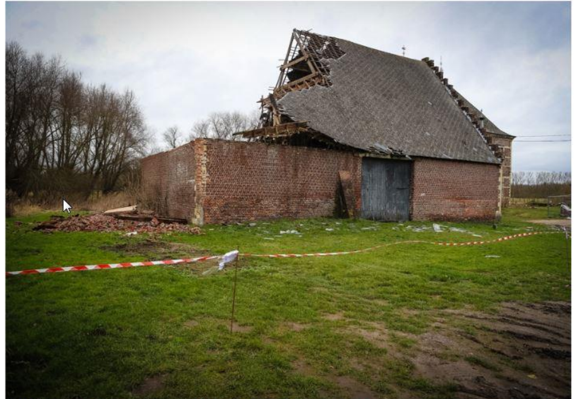
Het dak van het zusterverblijf is voor de helft weggewaaid. FOTO SVEN DILLEN
